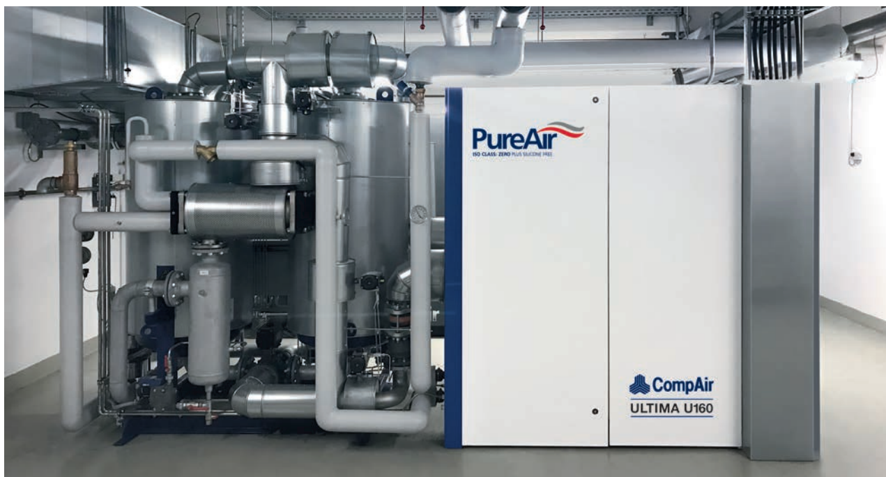
Para secar el aire comprimido húmedo, se utiliza un secador desecante HOC (calor de compresión) (izquierda). Este utiliza casi todo el calor residual del compresor para regenerar el desecante.
