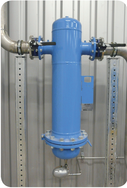
Für die zentrale Aufbereitung der ölfreien Druckluft sorgen Kältetrockner und Filter.
