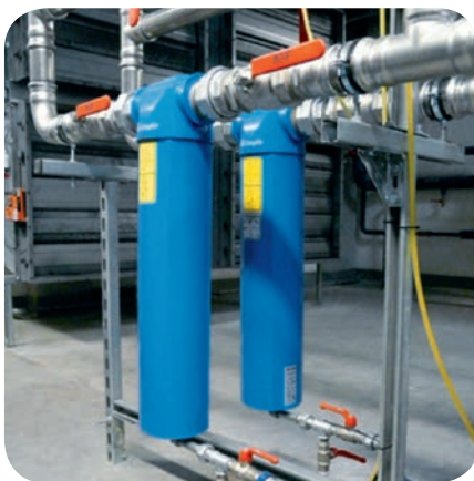
Auch die Kältetrockner sowie die Vor- und Nachfilter wurden von CompAir geliefert.
